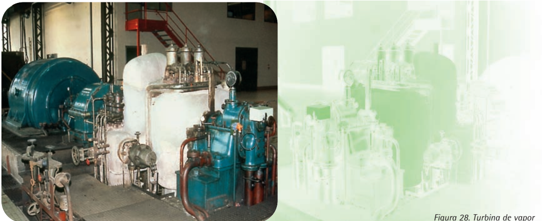
Figura 28. Turbina de vapor
