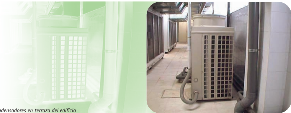
Figura 13. Condensadores en terraza del edificio
