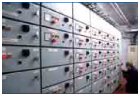
Las empresas de UNESA han desarrollado numerosos equipos eléctricos para mejorar la fiabilidad de nuestro sistema.
