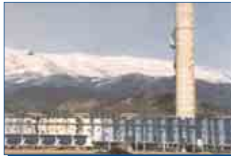
Central solar de colectores en la plataforma solar de Almería.
