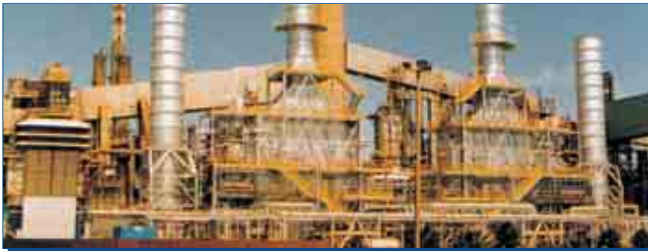
Central de cogeneración de Algeciras.
