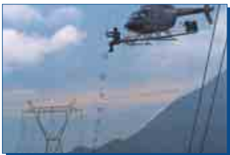
Para el mantenimiento de las grandes redes de transporte se utilizan helicópteros que mejoran la eficacia.
