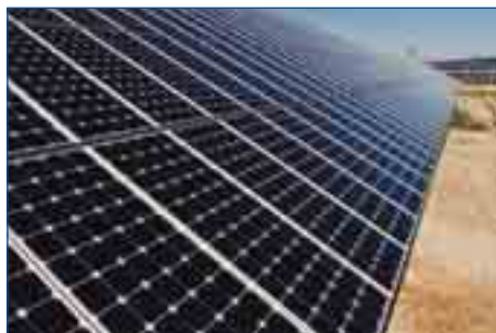
Paneles de una instalación solar fotovoltaica.
