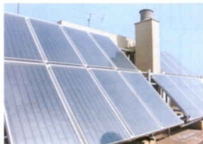
Figura 25 Sistema de captación de un grupo de viviendas en Sevilla (España)
