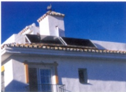
Figura 20 Captadores apoyados en voladizo
