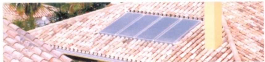
Figura 14. Incorporación de captadores a una cubierta inclinada
