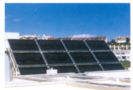
Figura 26 Captadores en cubierta. Estepona (España)
