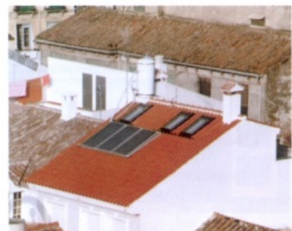
Figura 18 Vivienda con captador en cubierta
