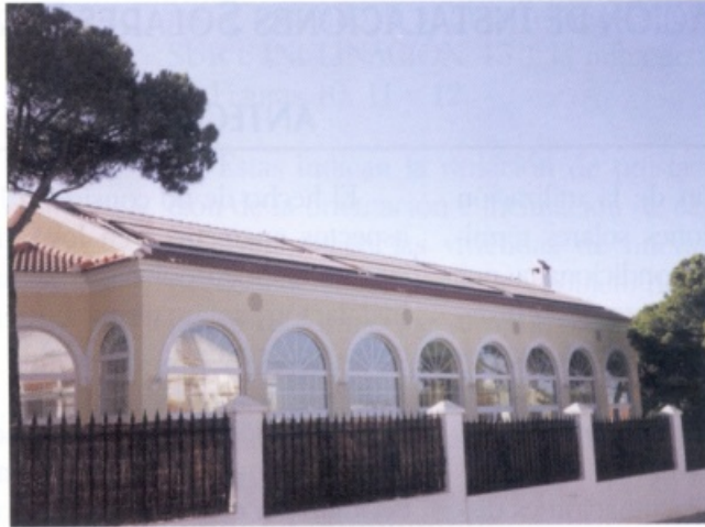
Captadores solares apoyados en cubierta
