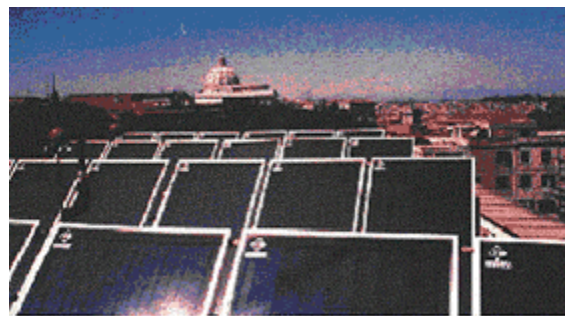
BATERÍA DE PANELES SOLARES SOBRE EL TACHO DE UN EDIFICIO
