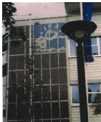
Módulos fotovoltaicos como revestimiento de un edificio
