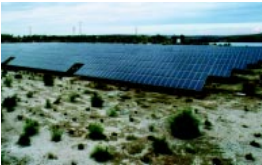
Central fotovoltaica de 1 MW de potencia en Toledo, construida por BP SOLAR España.
