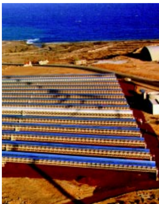
Central fotovoltaica de concentración del sistema "Euclides" de BP Solar en Tenerife de 500 kWp.
