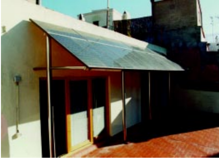
Vista de la CEFV de 2,2 kW de potencia de la fundación Terra conectada a la red eléctrica que ahorra 916,6 kg. de CO 2 anuales.
