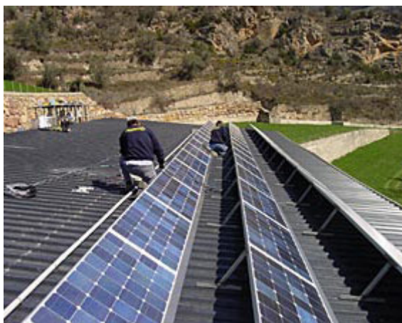
Instalación fotovoltaica sobre instalación agrícola
