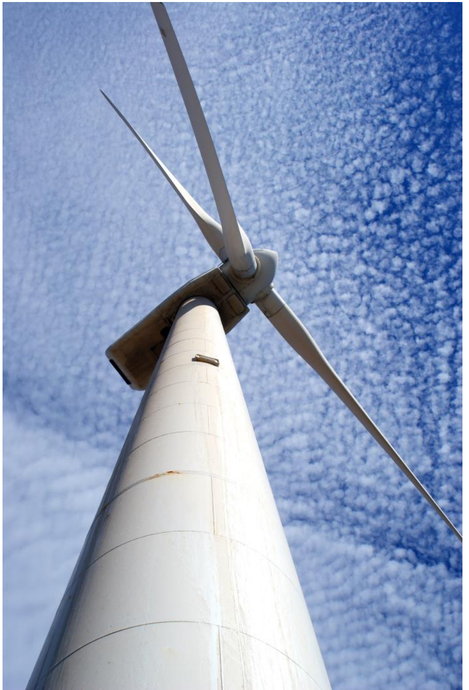
Detalle de Aerogenerador
