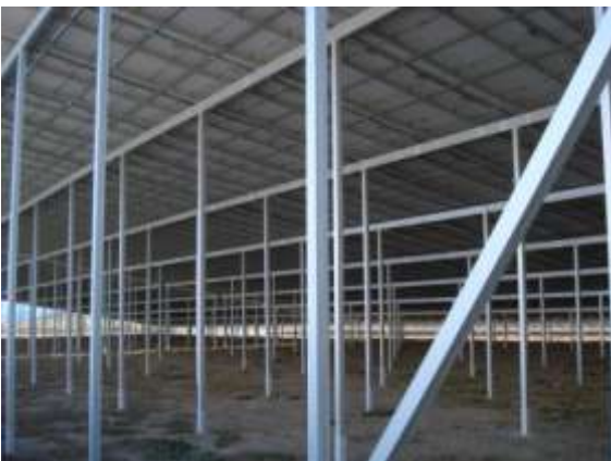
Estructuras Planta FV SOLTEN I (ITER – Tenerife)
