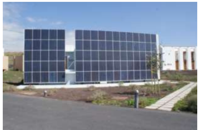
Instalación FV en fachada. Urbanización Bioclimática ITER (Tenerife)
