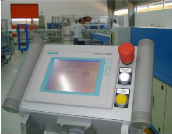
12. Detalle del panel de control
