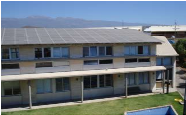
Instalación FV de 28 kW sobre cubierta. Edificio sede del ITER (Tenerife)
