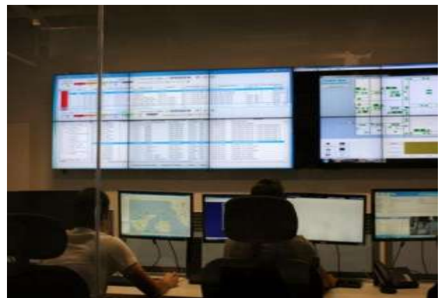
Ilustración 29. Vista de la sala del Centro de Control - ITER
