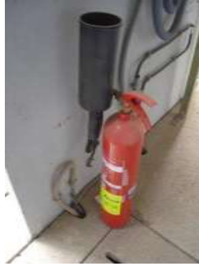
Ilustración 223. Elementos de seguridad: extintor
