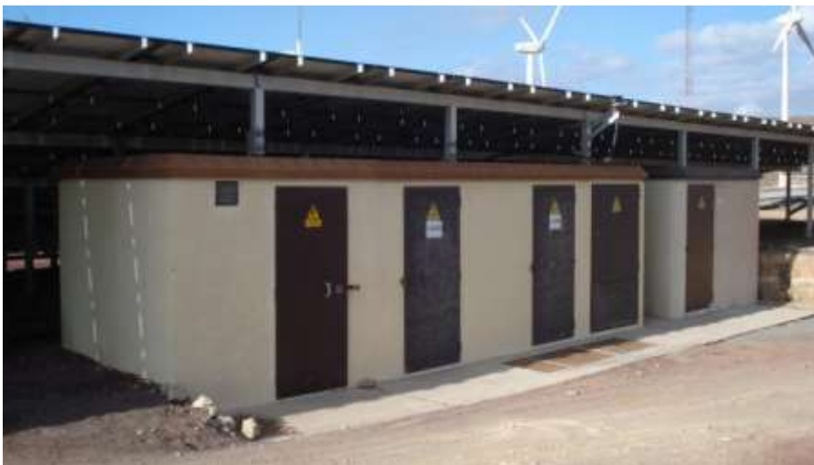
Ilustración 14. Vista de la Caseta de Inversores y el Centro de Transformación
