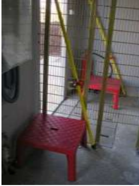
Ilustración 21. Elementos de seguridad: Banqueta, pértiga y extintor
