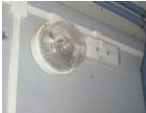
Ilustración 267. Iluminación de emergencia
