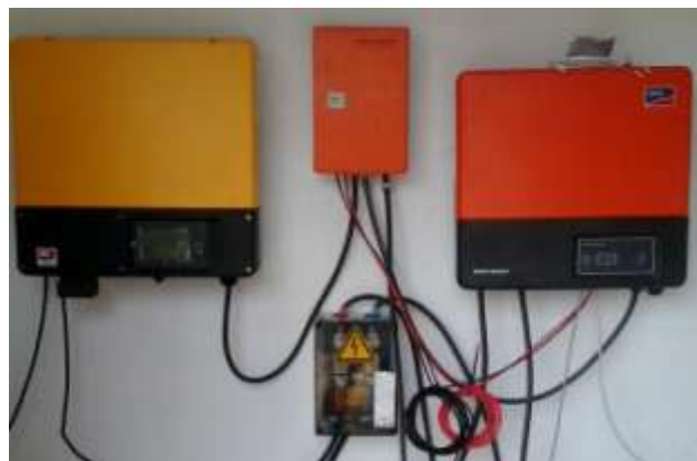
Ilustración 9. Inversores en local técnico
