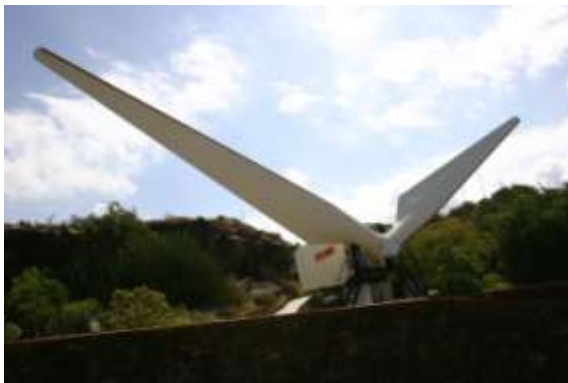
Ilustración 16. Vista del Aerogenerador WEG de 250 kW
