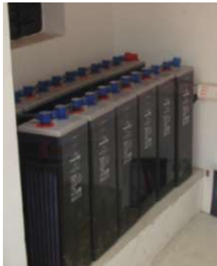
Ilustración 10. Banco de Baterías en local técnico
