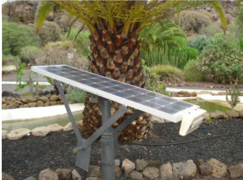
Ilustración 12. Vista del Panel Fotovoltaico Orientable
