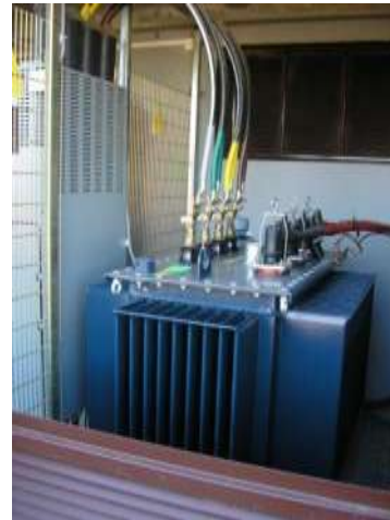
Ilustración 15. Vista del Transformador
