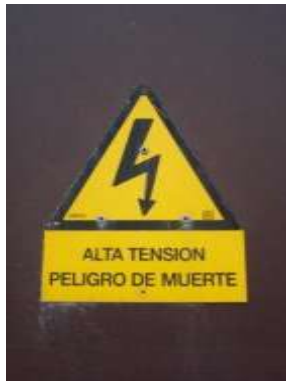
Ilustración 20. Señalización de emergencia
