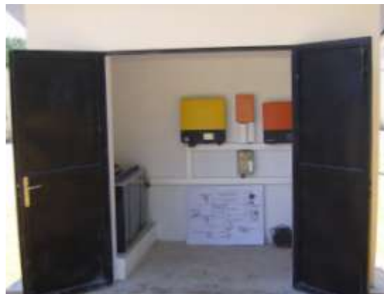
Ilustración 2. Interior del local técnico
