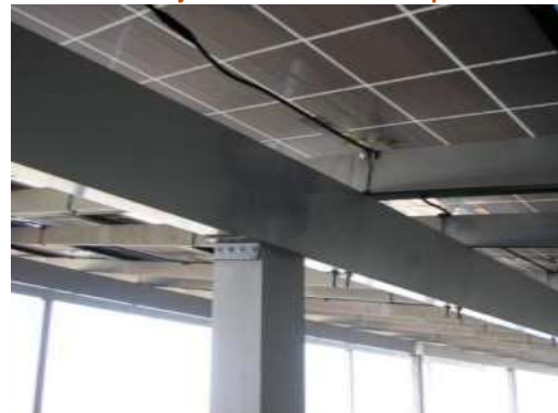
Ilustración 6. Cableado de paneles FV bajo la estructura
