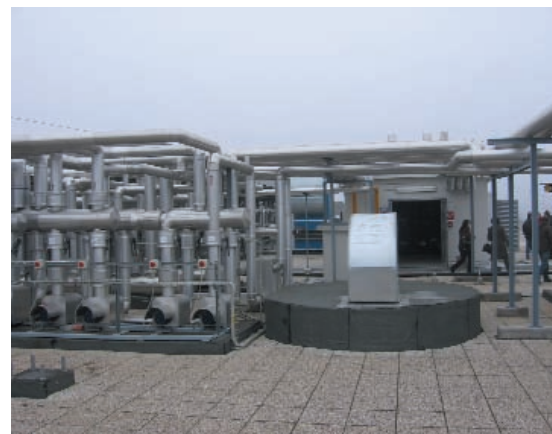
Sistema de cogeneración en la cubierta de la Casa Consistorial de Formigine (Italia).
