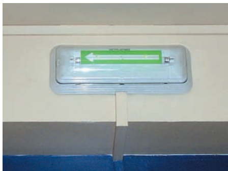
La iluminación de emergencia de los edificios sigue siendo mayoritariamente de balizamiento mediante bombillas de incandescencia. La potencia unitaria de estas bombillas es muy baja, pero se mantienen encendidas permanentemente durante todo el año. Su sustitución por sistemas LED supone un gran ahorro energético acumulado. Foto José Manuel Jiménez Bolaño.
