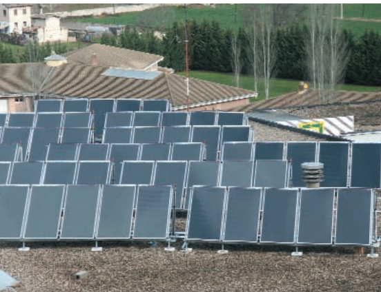
Colectores solares térmicos en la cubierta de la Asociación Deportiva Anaitasuna. Foto Acciona Energía.
