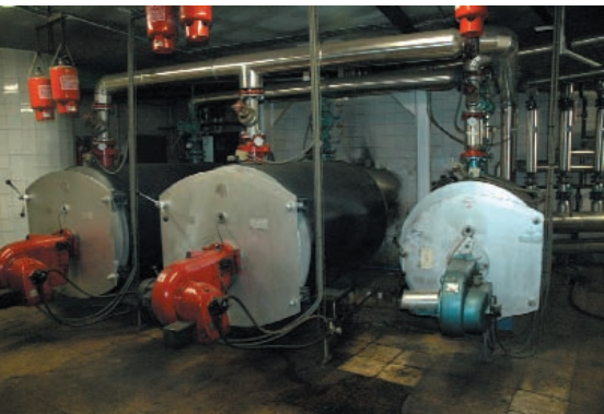
Sala de Calderas. Fotografía José Manuel Jiménez Bolaños
