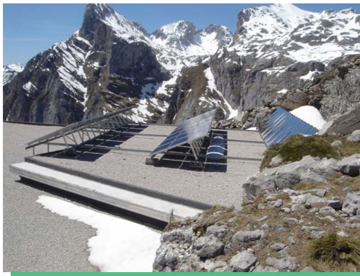
Figura 8.7: Instalación solar de Fuente Dé
