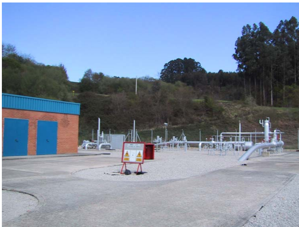
Figura 9.8 - Entrada-salida del Gasoducto Burgos-Asturias en Villapresente.
