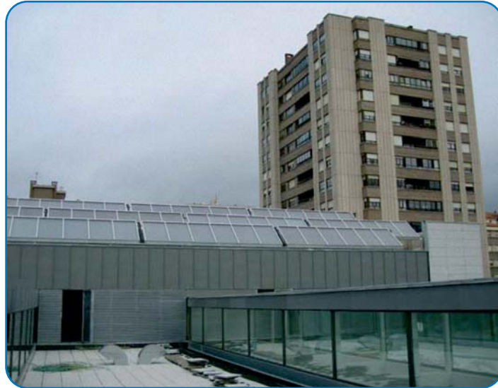
Figura 6: Instalación solar térmica en el Centro Cívico Iturrama. (Fuente: Agencia Energética del Ayuntamiento de Pamplona)
