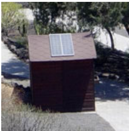
Electrificación Aislada con FV
